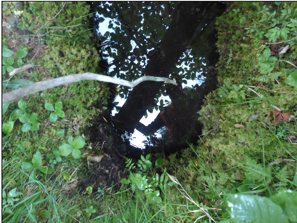
Photo 34 Obstacle infranchissable à la migration du poisson (de type souterrain), cours d'eau CE09 (2016)
